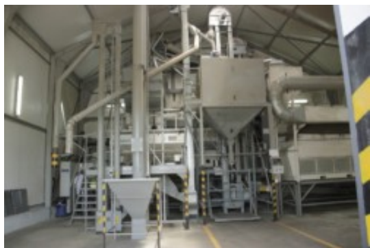
Linia czyszczenia – Zakład w Runowie
