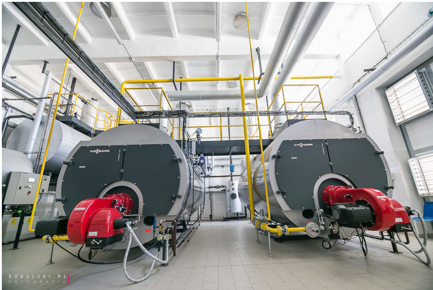
Kotłownia w zakładzie w Kolnie. (fot. SM Mlekpól)
